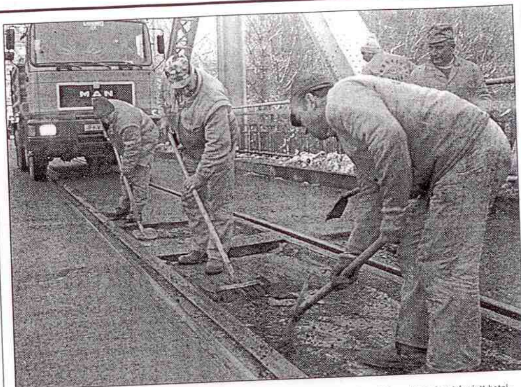
A tiszai híd kátyúzása többórás forgalomkorlátozást okozott tegnap kedden a 44-es főúton. A fagy és a hó miatt hatalmas gödrök, árkok keletkeztek a régi híd burkolatán. A jelenség nem új keletű, szinte havi rendszerességgel nehezíti a közlekedést. Az autósoknak most is várniuk kellett.
